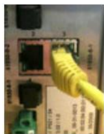
Figura 14: Conexão Ethernet (M2-J3)
