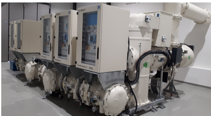
Image 14 : PSEM 123 kV isolé au g^3 installé et mis sous tension au poste électrique d'Etzel d'Axpo en 2018
