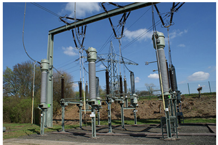
Image 3 : Transformateurs de courant 240 kV sans SF_6 , utilisant à la place du g^3 , installés au poste de TenneT en Allemagne
