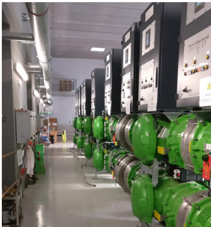
Image 15 : PSEM de type F35 72.5 kV isolé au g^3 installé au poste de RTE à Grimaud en France
