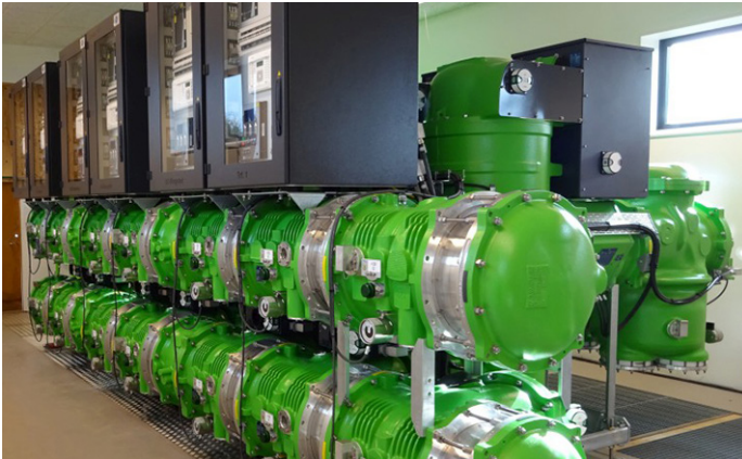
Image 1 : Le poste sous enveloppe métallique/PSEM de type F35-72.5 kV g^3 de CERIUS, constitué de 6 travées disjoncteurs, est installé au Danemark
