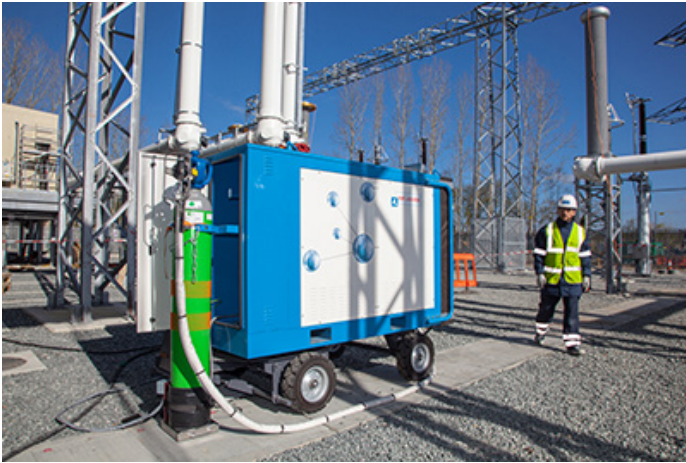
Image 4 : Le chariot de remplissage g 3 d'Air Liquide en service sur un site de National Grid au Royaume-Uni
